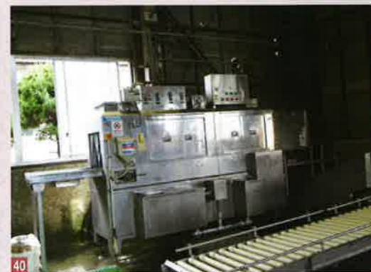
39,40 原料の通りコンテナを洗浄する建屋。洗浄機で効率的に洗浄し、コンテナを繰り返し使う。
