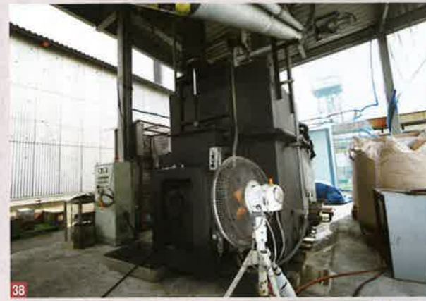
38 バイオマスボイラー。排水に含まれる油分を回収し、高温で燃焼する。
